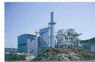
バイオマス火力発電所
